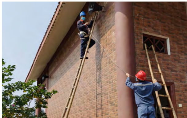
广西公司在广西壮族自治区南宁市武鸣区推广“天翼大喇叭”覆盖 1220 个自然村，共 70 万农村居民，有力保障疫情防控信息的传递。图为 2020 年 3 月 9 日，装维员工正在双桥镇八桥村大伍屯安装“天翼大喇叭”
