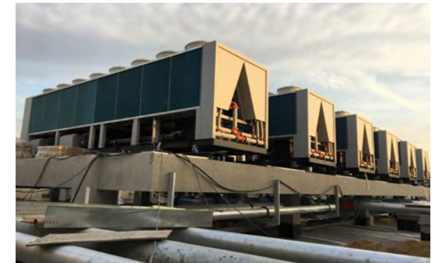
2020 年 1 月，安徽公司天都路数据中心机房风冷式冷水空调安装现场
